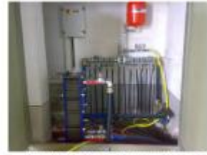
Il locale tecnico, dove sono alloggiati i componenti del sistema
