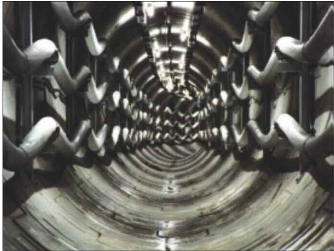
Figura 5 Cavi AAT installati in un tunnel profondo 20 m sotto Berlino.
