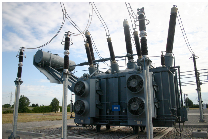
TRASFORMATORI TRIFASI (ELEVATORI)
