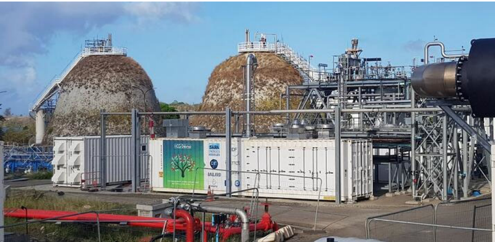
Ballard PEM 1 MW
