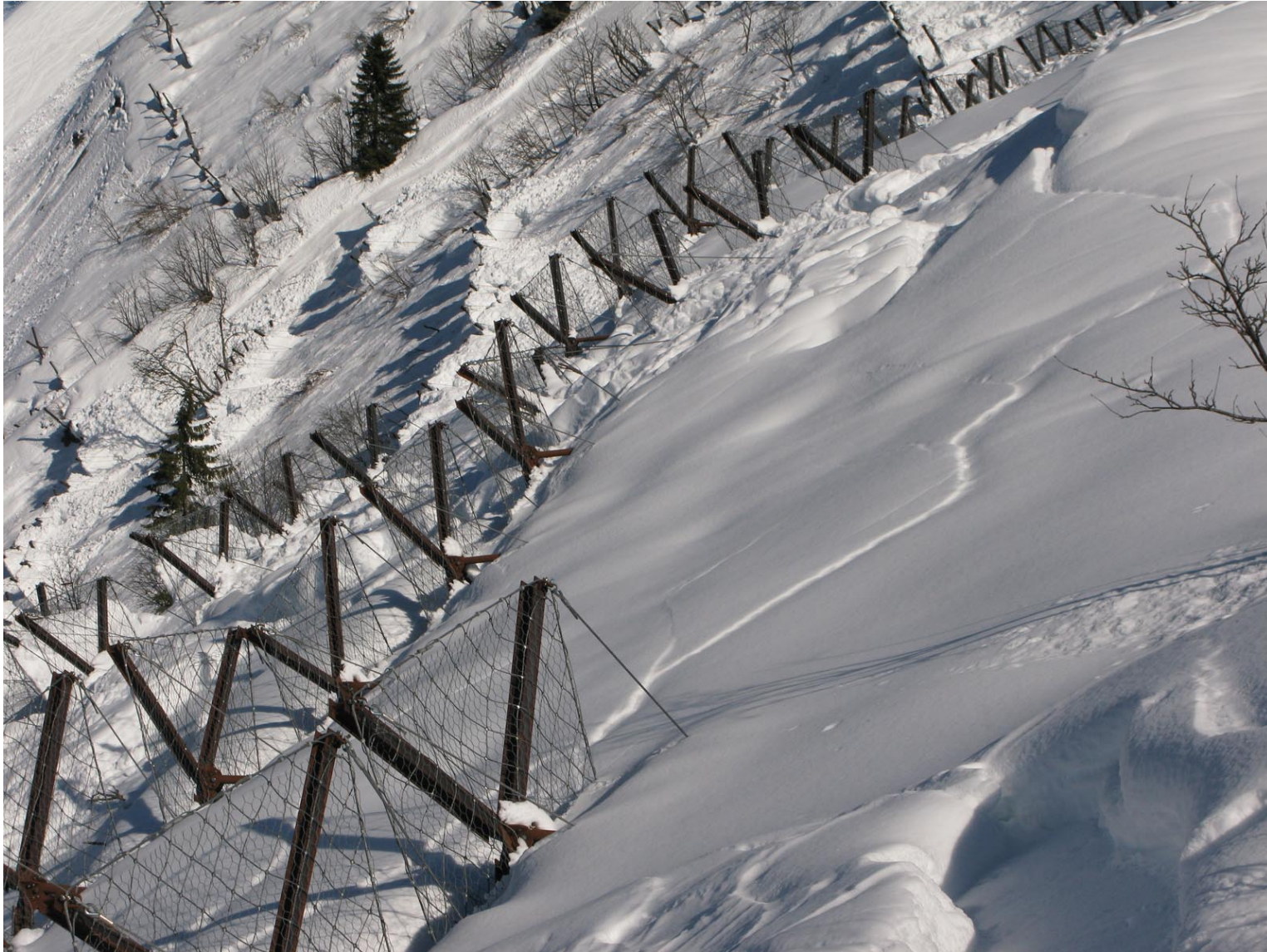
Reti da neve in cavi d'acciaio
